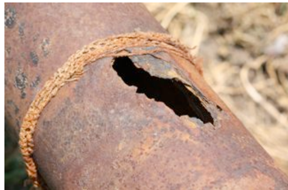
Korrosionsschaden an einer Abwasserleitung
